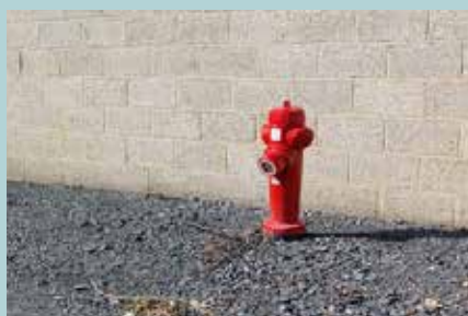
Nouvelles bornes incendie, avenue de la République et rue d'Ovillers
